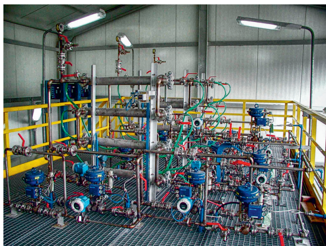
Rys. 3. Instalacja membranowa oczyszczania ścieków glikolowych
